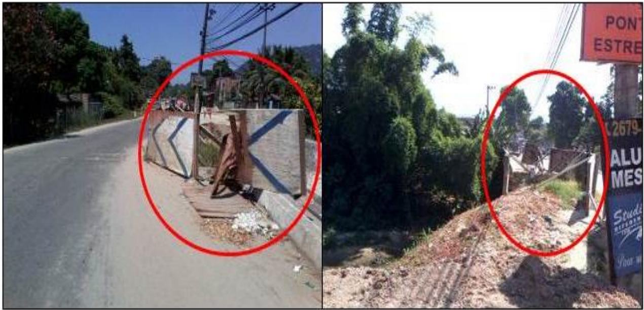
Figura 9: Ponte que cedeu com a cheia do rio
