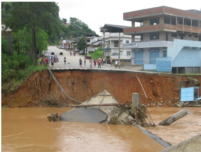
Figura 2 - Queda da ponte da Rodovia RJ-116 sobre o Rio Grande
