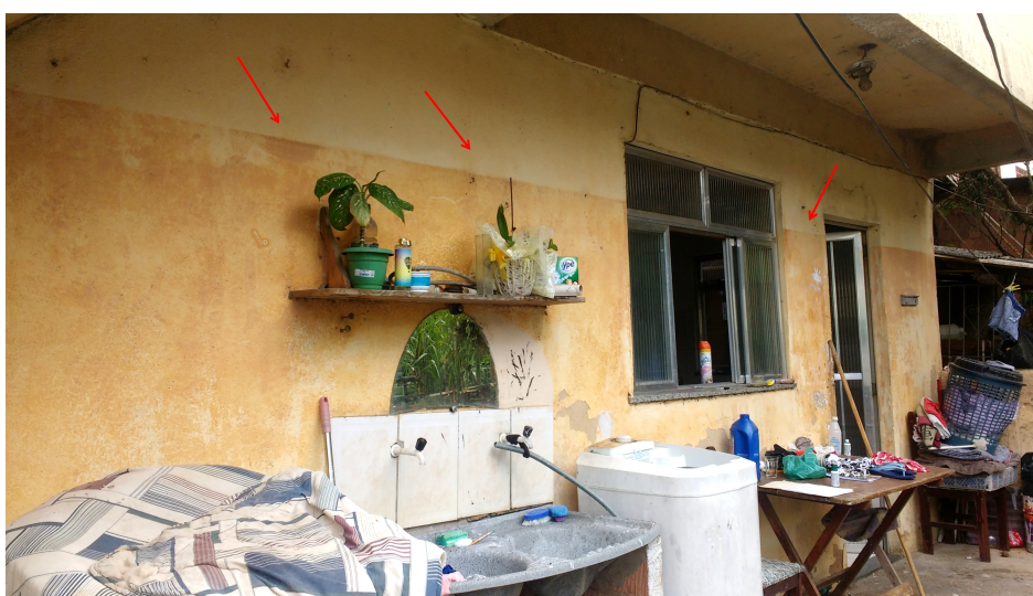
Figura 5 – Fotografia da residência atingida pela inundação de 2011
